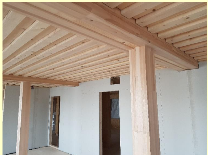
Patinoire de Porrentruy, supports et poutres en hêtre collé Fagus
